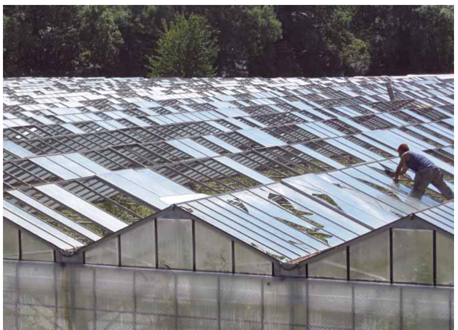
Schadentag 23. Juli 2009: Zum Teil tennisballgroße Hagelkörner verursachten schwerste Schäden in Österreich und der Schweiz.
