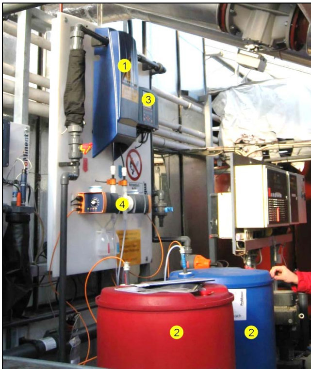
Foto 1: Chlordioxidanlage, zu sehen sind: Mischreaktor (1), Kanister-Ausgangskemikalien (2), Dosierungseinheit (3), Dosierungspumpen (4)
