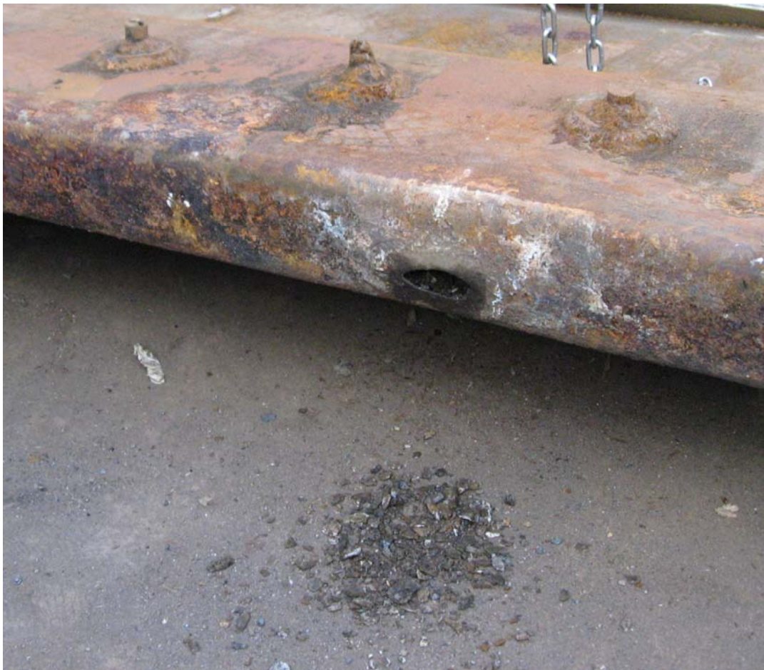
Durch massive Kalkablagerung durchgebrannte Kühlbrücke / Wassertasche
