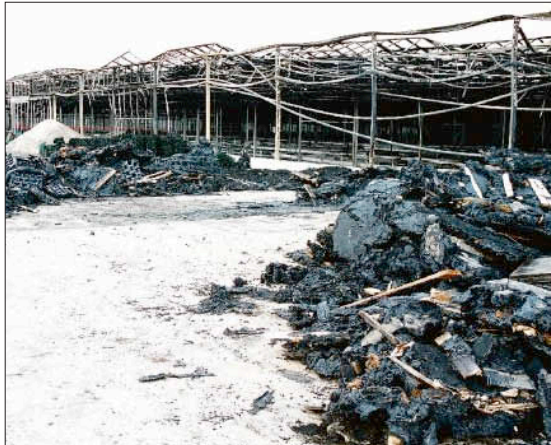
Vorsätzliche Brandstiftung war hier die Ursache. Außen angelagertes Verpackungsmaterial wurde an drei Stellen angezündet. Vom Stehwandbereich aus verbreitete sich das Feuer über die B3-Schirme und Mobiltsche rasend schnell aus. Schadenshöhe: 2,8 Millionen Euro.
