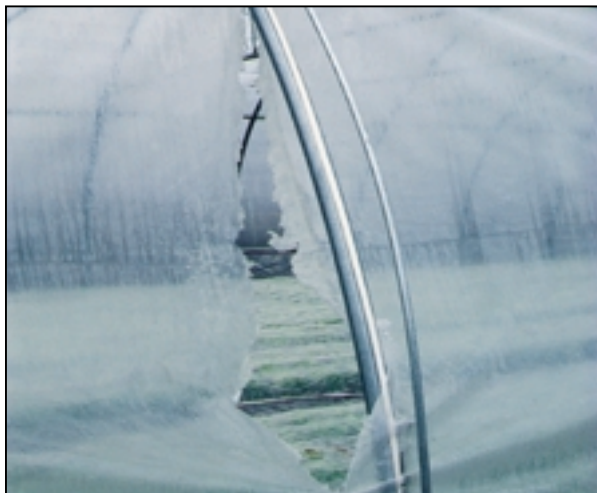
↑ Alterungs- oder abnutzungsbedingte Beschädigungen an Folien gefährden das gesamte Haus.
