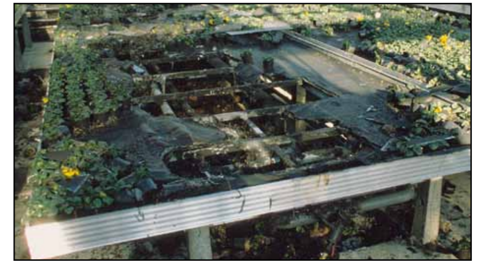
Abbildung oben: Tischauflagen aus Kunststoff sind brennbar und führen zur Ausbreitung eines Feuers.
