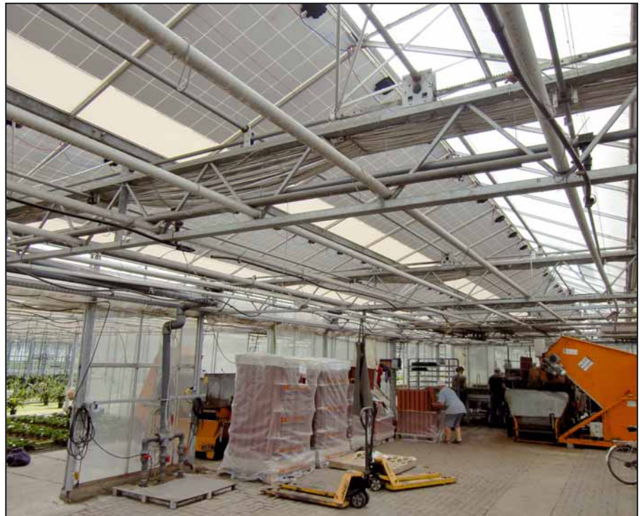
Bild 6: Eindeckung auf einer Arbeitshalle – Es werden gleichzeitig zwei Ziele erfüllt: Stromerzeugung und Beschattung der Arbeitsplätze.
