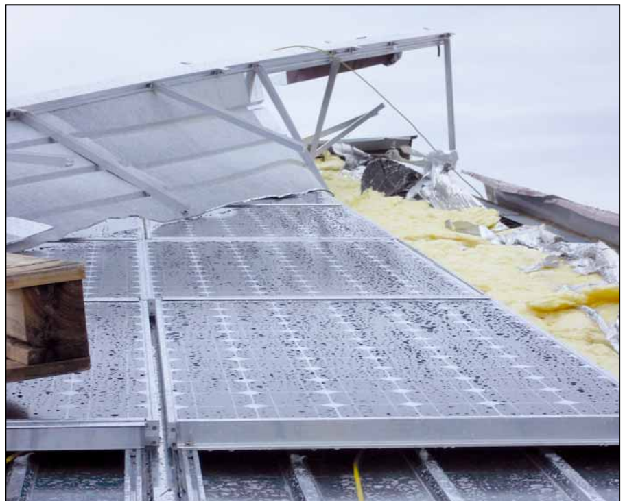
Bild 2: Durch Sturm beschädigte Dachhaut einer Lagerhalle mit aufliegenden PV-Modulen. Zusätzliche Stabilität im Dachbereich können Sturmsicherungen an Giebeln und an den Befestigungen der Module schaffen.
