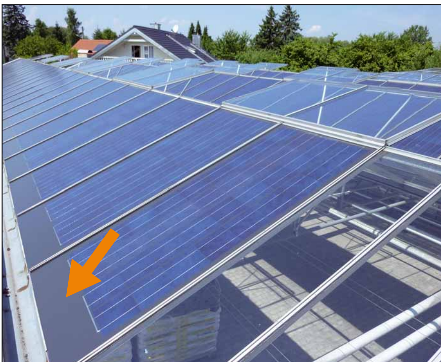
Bild 5: Photovoltaik-Module im Dach integriert über einer Arbeitshalle – Der untere Teil der Scheibe ist frei von Solarzellen, da eine Beschattung durch die Nachbarkappe erfolgt.
