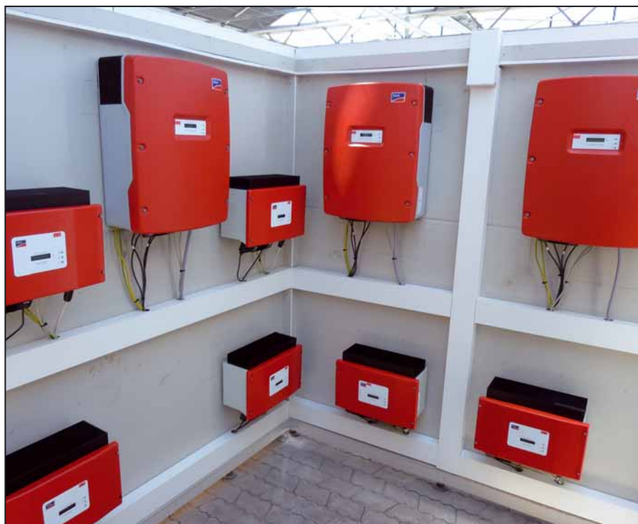
Bild 3: Die Wechselrichter – Bei Montage ist auf den Brandschutz zu achten.
