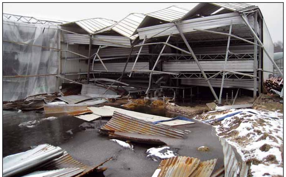
Bild 2: Die Druckwelle aus dem geplatzten Tank hat die Venlohauskonstruktion stark beschädigt.
