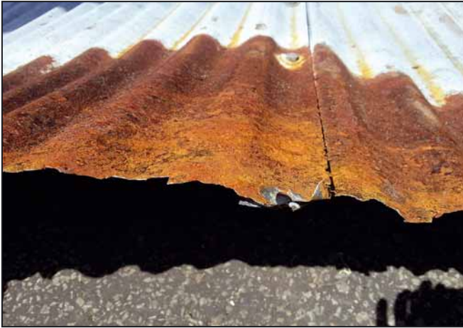
Bild 3: Starke Rostbildung auf der Innenseite des gerissenen Wellblechs
