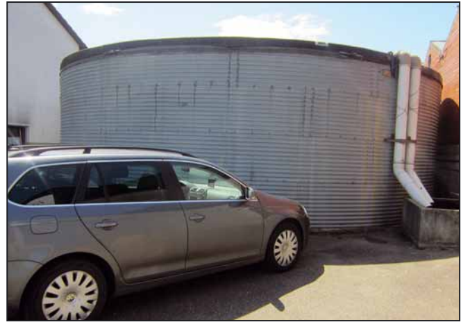
Bild 5: Ohne Anprallschutz können hier schnell Schäden entstehen.
