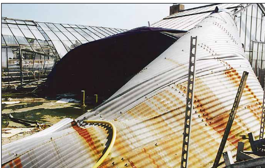
Bild 4: Austretende Rostflecken haben bei diesem Tank schon frühzeitig die Korrosion von innen angedeutet. Eine rechtzeitige Wartung hätte diesen Schaden verhindern können.
