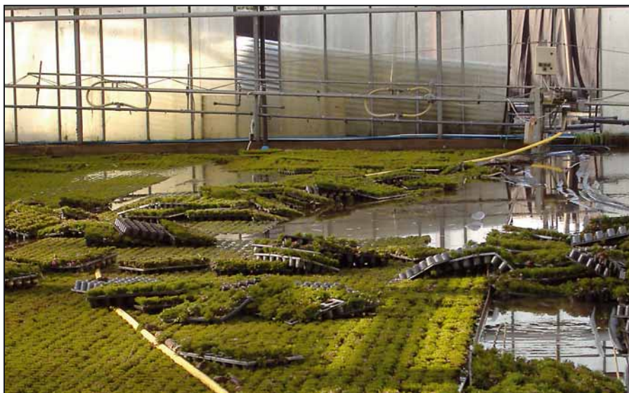
Bild 1: Kulturschaden im Gewächshaus nach gebrustem Wassertank hinter Giebelwand.
