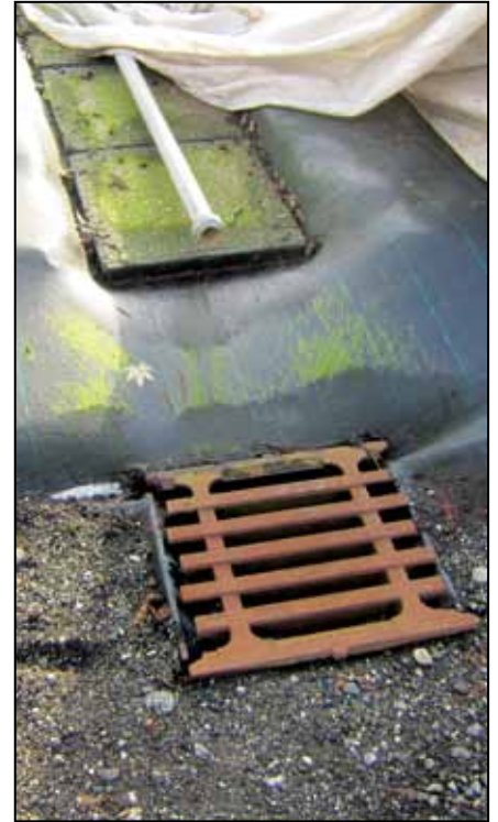
Bild 3: Für eine funktionsfähige Entwässerung Gullys immer von Laub, Substratresten und Verschmutzung freihalten.
