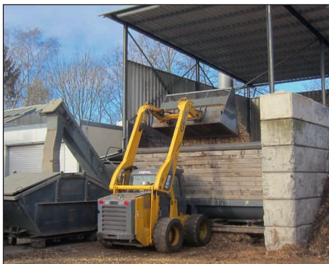
Foto 3: Beschickung des Brennstoffbunkers per Radlager
