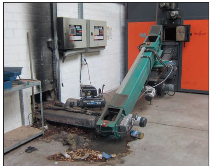
Foto 7: Rückbrand aus Brennstoffbunker in die Brennstoffförderung
