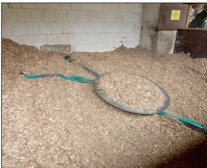
Foto 5: Gelenkarmaustragung (Foto Firma döpiK Energietechnik GmbH)
